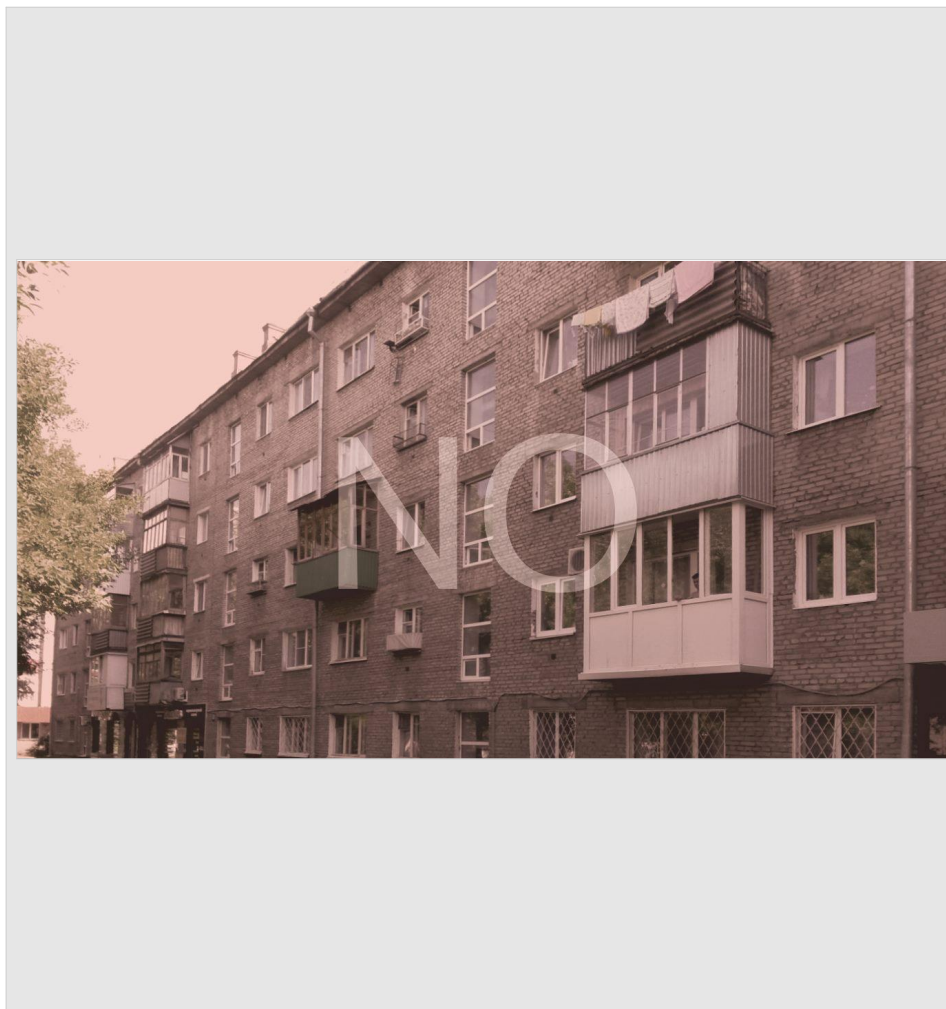
Рис. 4.3.1. Пример недопустимого устройства балконов на фасаде здания
